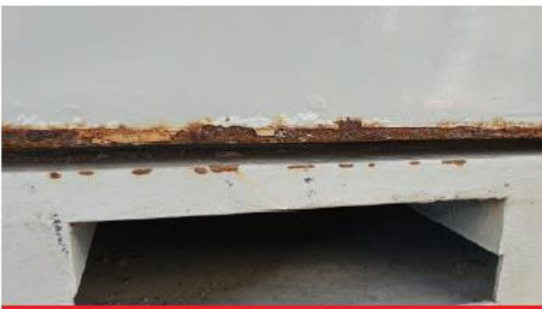
Фото. Слабка адгезія покриття на гострих краях нижніх опор контейнера.
